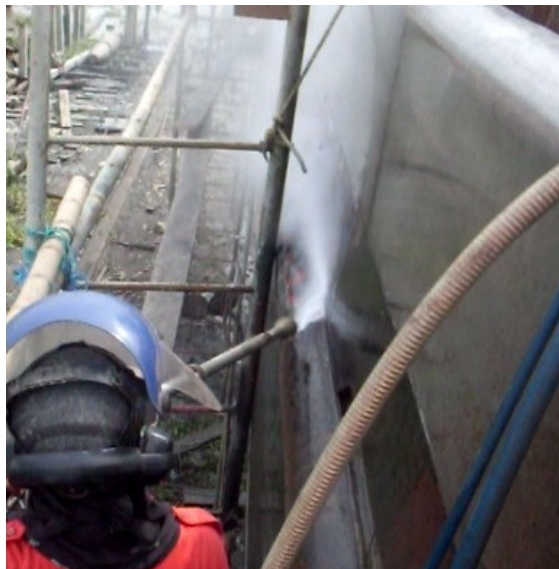
Figura No. 18 Sistema de hydroblasting de última generación
