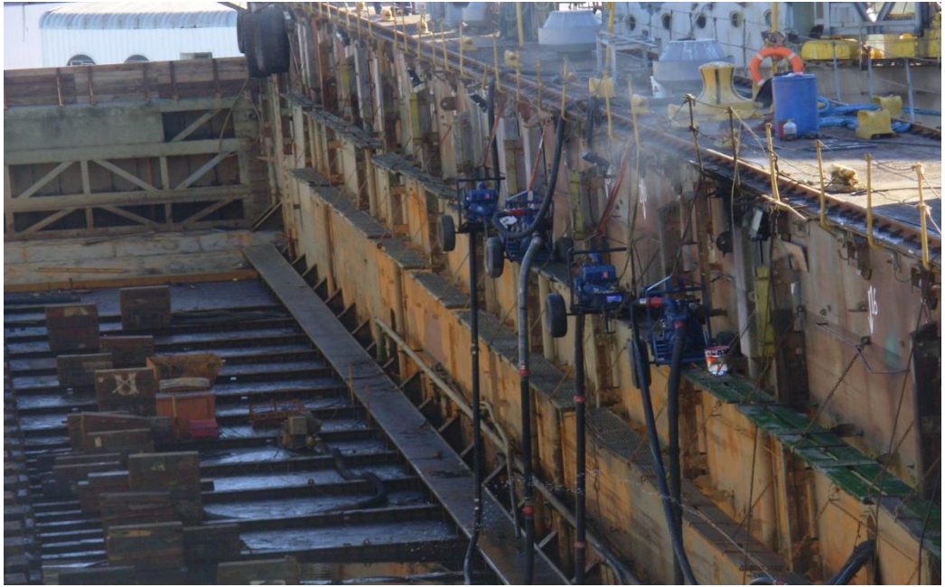
Foto N°14 Ubicación final de las bombas de achique a combustión.
