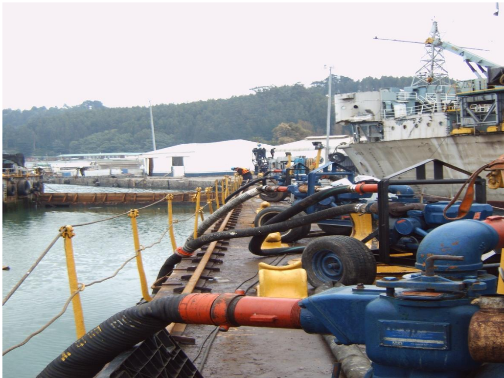
Foto N°12 Distribución de bombas de achique.
