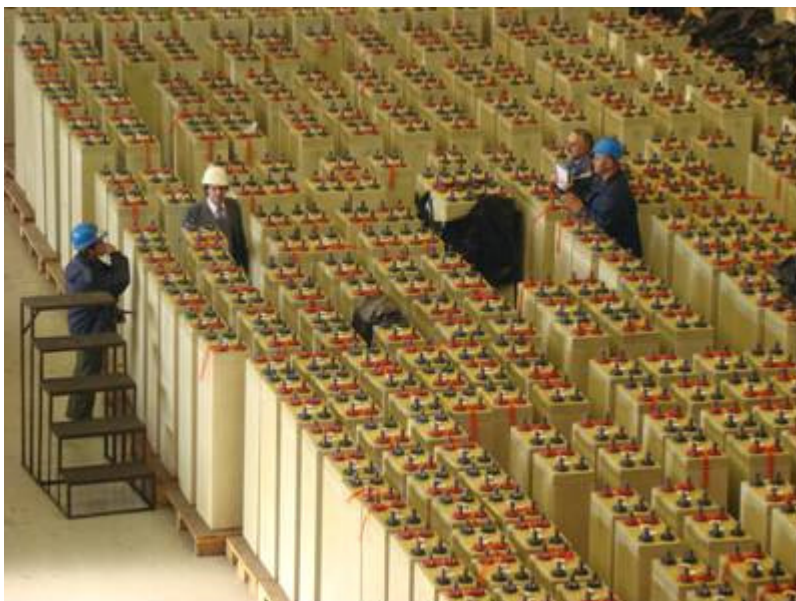
Lote de baterías replacadas
