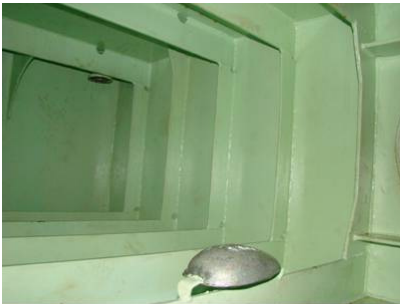
Tanque de combustible
