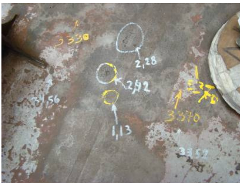
Medición de pitting sobre casco resistente
