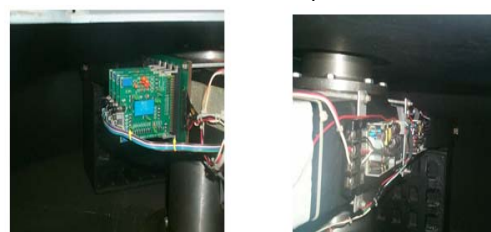
a) Vista dos condicionadores
