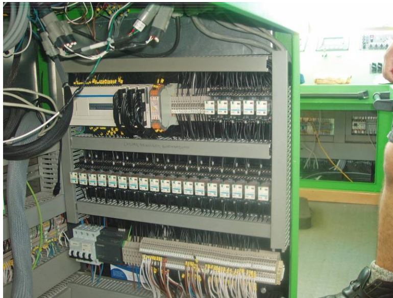
Fig. 4. Maniobra eléctrica del PLC bajo pupitre en el puente en un buque remolcador.
