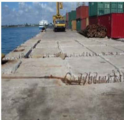
Figura 4. Juntas sin hormigonar
