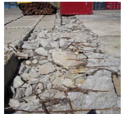
Figura 6. Deterioro en juntas y falta de estanqueidad
