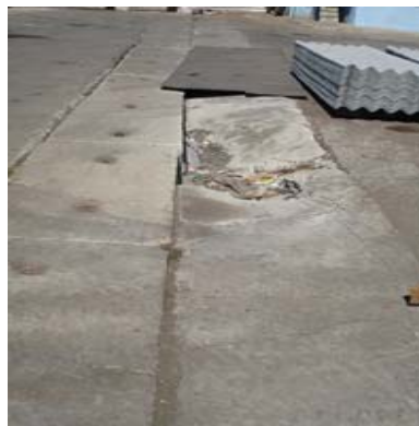
Figura 5. Hundimiento en pavimentos y redes técnicas
