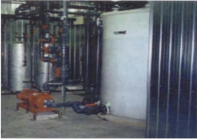
Foto 2 Sistema de purificación de agua de una municipalidad en New Brunswick
