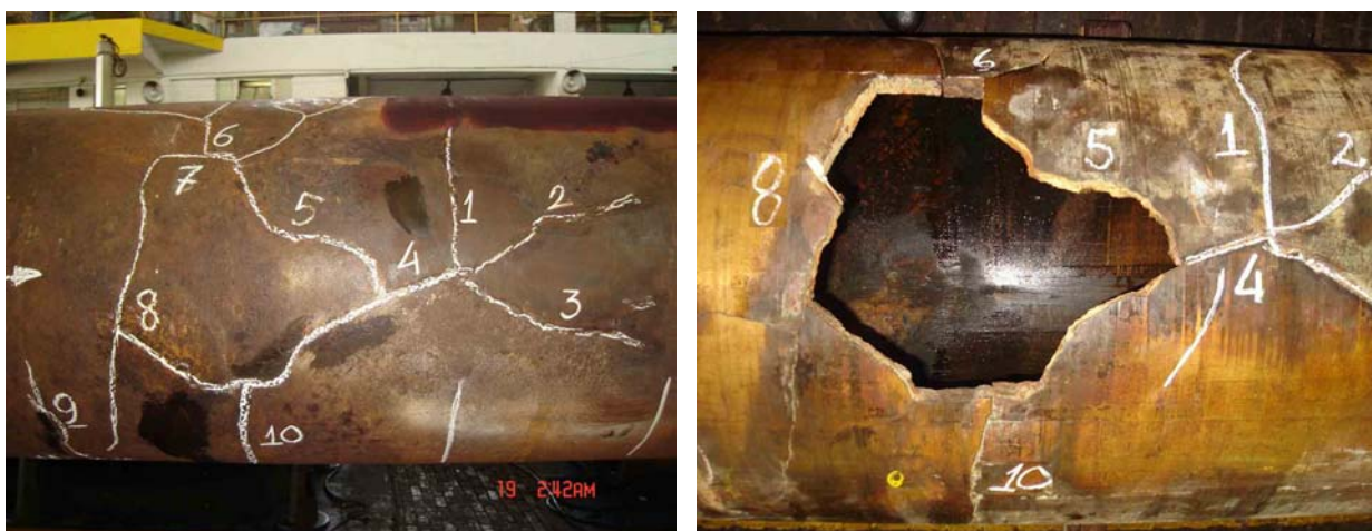
Figura 23. Vista do eixo com realce das linhas de corrosão e vista da camisa com realce das trincas coincidentes com a corrosão do eixo.
