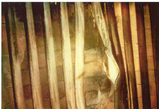
Figura 8 – Tubo rompido no interior da fornalha.
