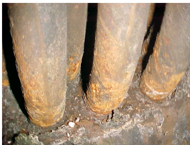
Figura 9 – Ataque corrosivo nos pés dos tubos no interior da fornalha.
