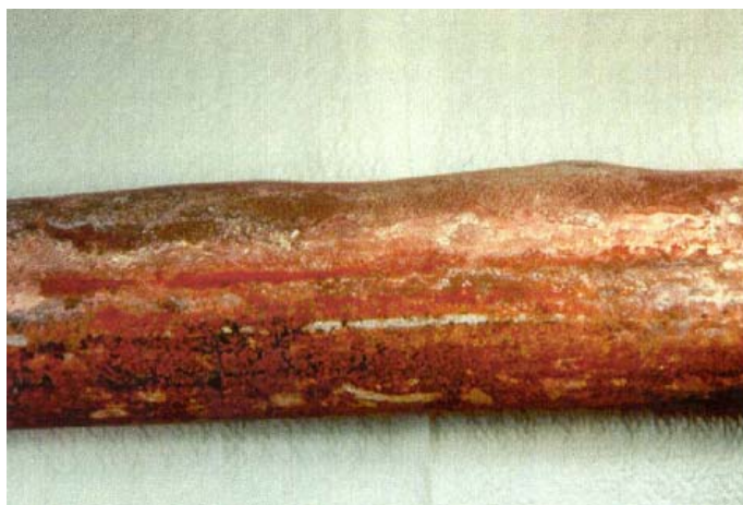
Figura 7 – Tubo com sinais de sobreaquecimento
