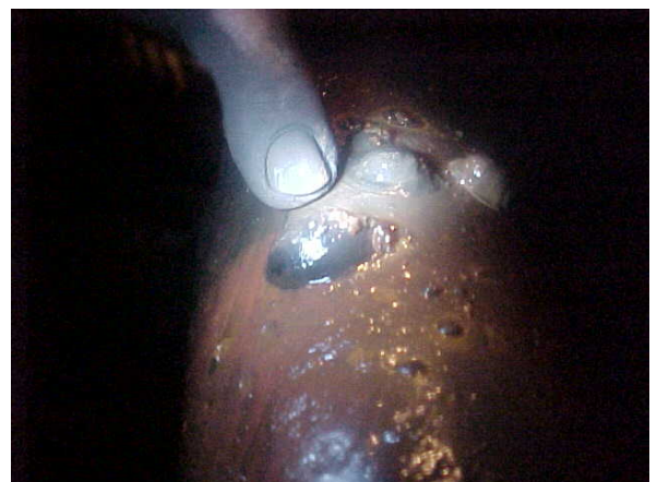
Foto 13 – Pitting e tubérculo
