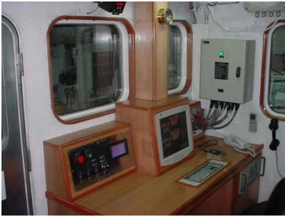
Figura N° 10. Sala de Control final
