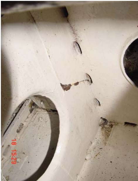
Figura N° 3. Grieta en la vagra central
