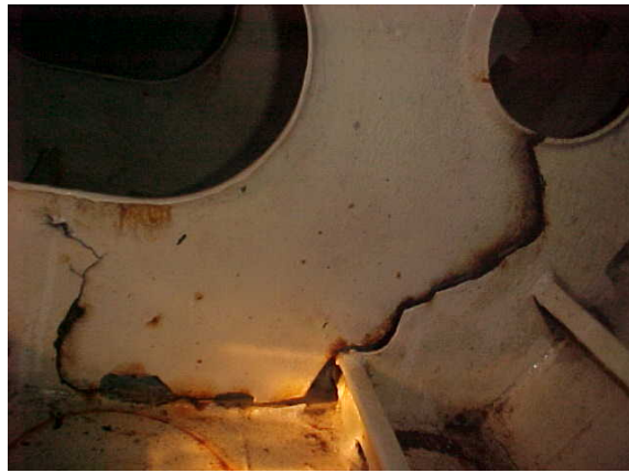
Figura N° 6 Falla en sector de cuaderna
