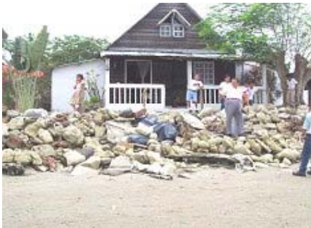
Foto 3. Vivienda expuesta a la acción erosiva del oleaje en Cojimíes. Se aprecia el enrocado de protección y sacos de arena que han sido colocados para proteger la misma.
